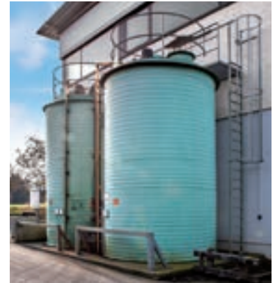
Depósitos de sustancias químicas en una potabilizadora.
