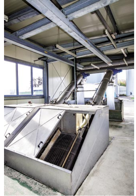
Rejillas de cribado en una depuradora de aguas residuales.
