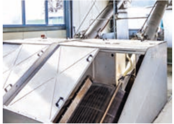
Rejillas de cribado en una depuradora de aguas residuales.
