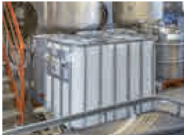
Depósito IBC con productos químicos distintos y con rangos de medición pequeños.
