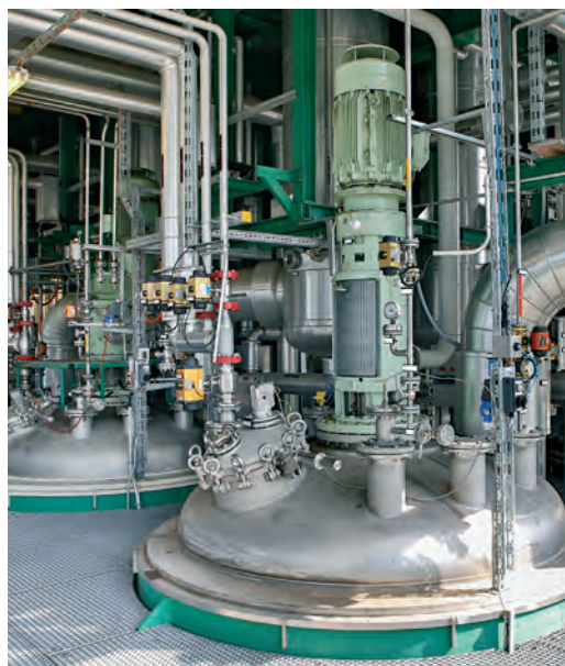
Reactores en planta química.
